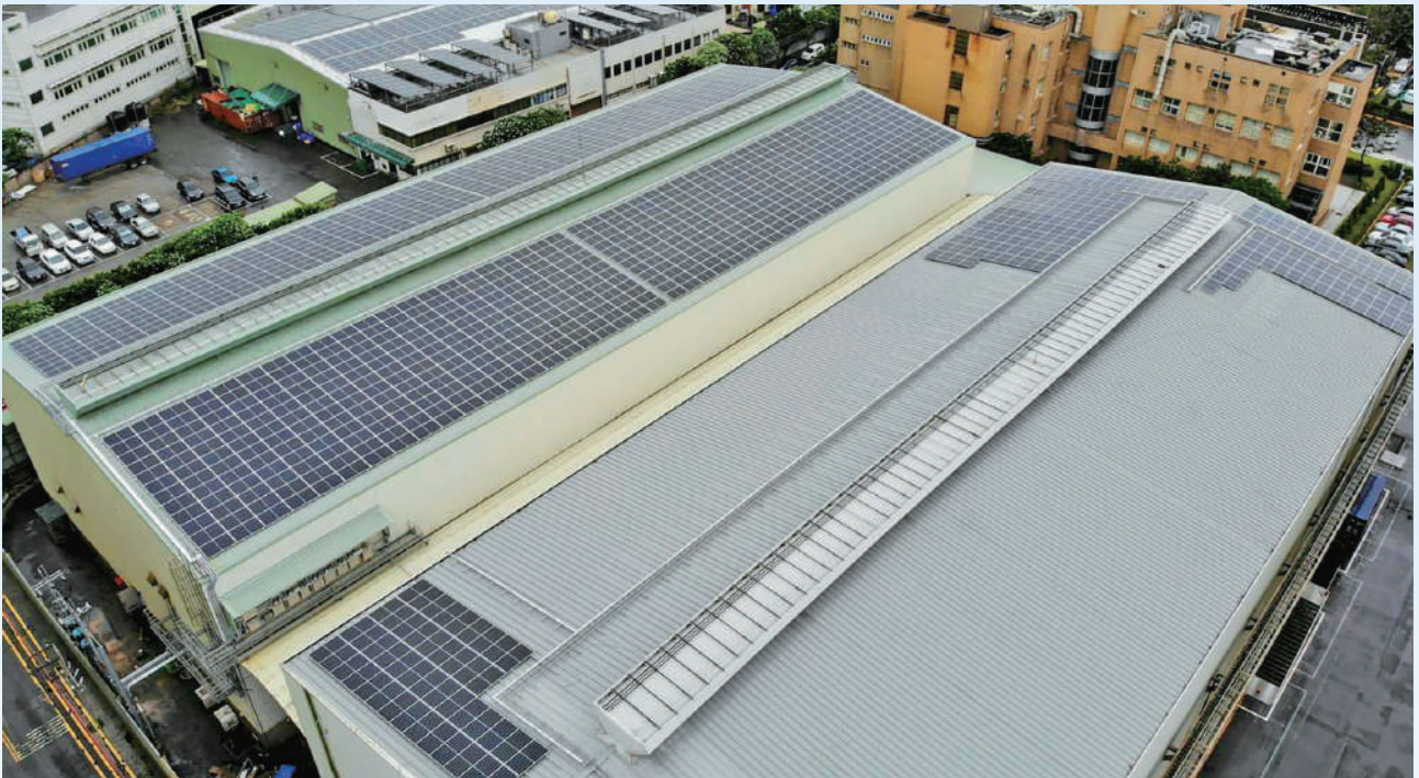
▲二廠物流倉庫屋頂建置太陽能板。
