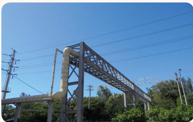
華亞汽電共生管橋高架輸送
